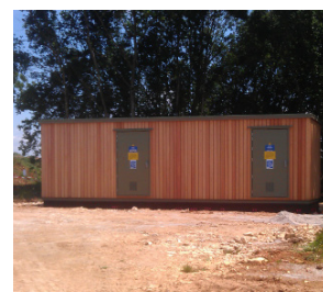
Intégration d'un poste de livraison
