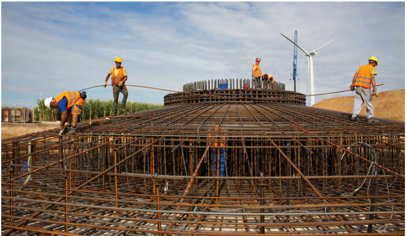
Cimentación del parque eólico de Wennerstorf: En el proyecto de repotenciación, cuatro equipos más antiguos fueron reemplazados por dos modernos. Con los dos generadores Nordex N149 de 4.5 megavatios, el nuevo parque eólico produce tres veces más energía que su predecesor.
