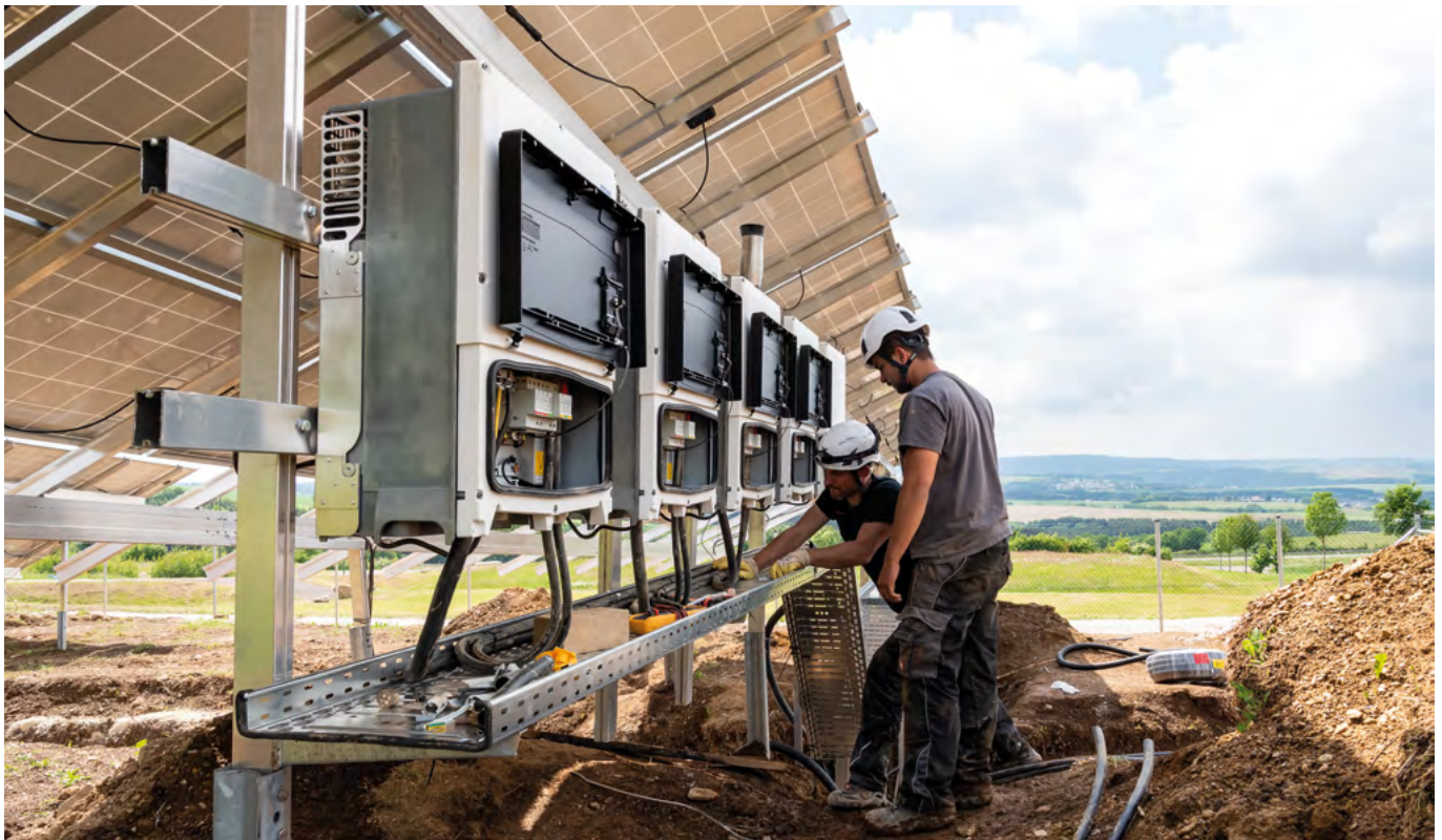
El desarrollo de parques solares está desempeñando un papel cada vez más importante en ABO Wind. La foto muestra a electricistas construyendo un proyecto en Malborn, Renania-Palatinado.
