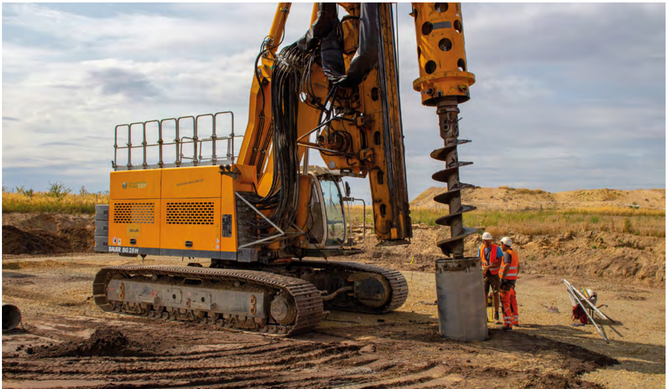
Los expertos en construcción de ABO Wind construyen cimientos estables para aerogeneradores incluso en condiciones difíciles. Esto lo han demostrado en la construcción del parque eólico Forst Briesnig en una antigua zona minera de carbón en Lusacia.
