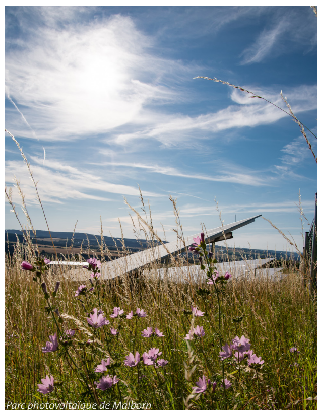
Parc photovoltaïque de Malborn
