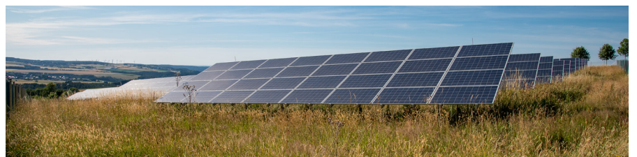
Parc photovoltaïque de Malborn (Allemagne)
