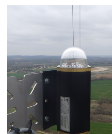
Balise Signalisation lumineuse aérienne
