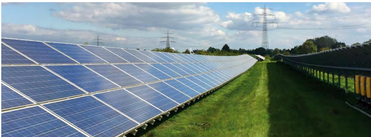
© ABO Wind – Table de modules - Parc photovoltaïque de Malborn en Allemagne
