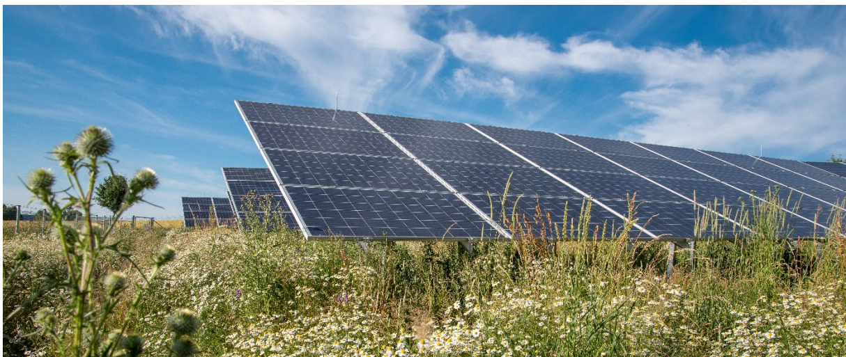
© ABO Wind - Parc photovoltaïque de Malborn en Allemagne
