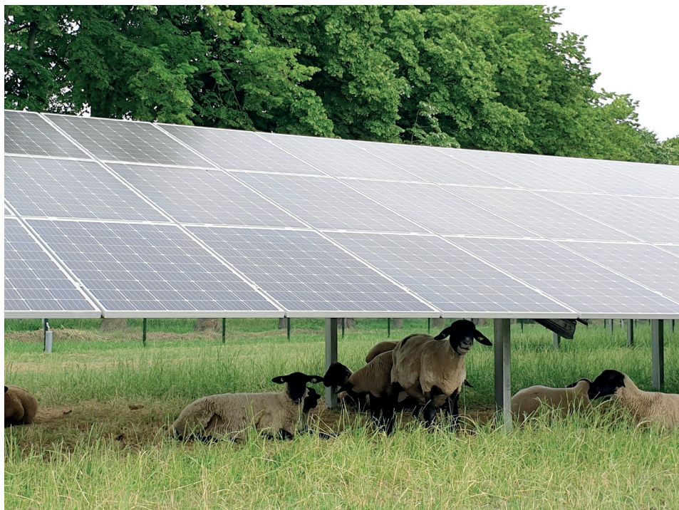
↑ Parc photovoltaïque Kevalear en Allemagne
