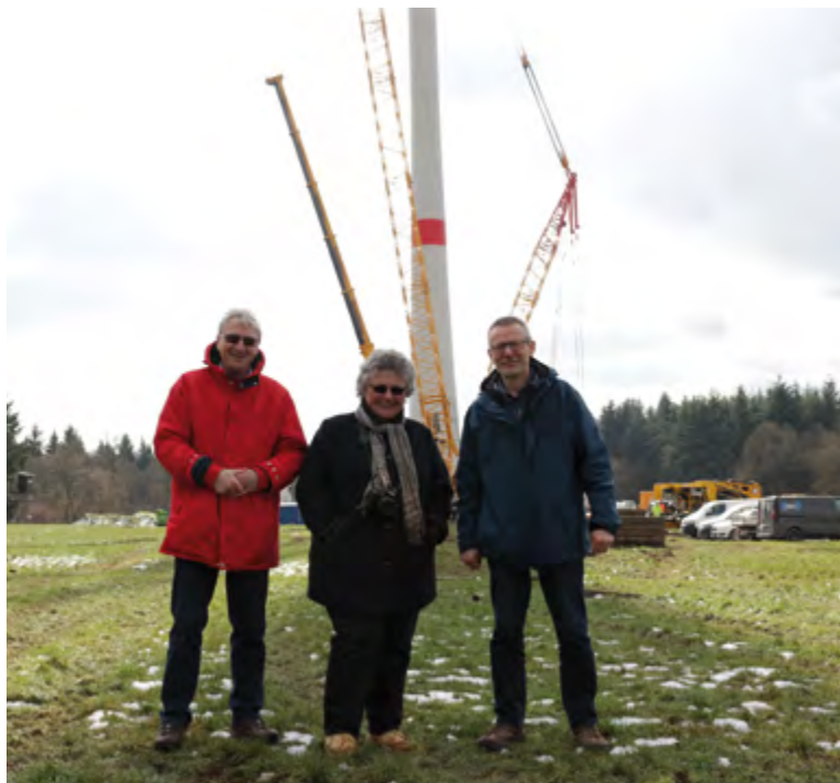
Dr. Gerhard Kissel und Dr. Petra Gruner-Bauer (beide Vorstand der SOLIX ENERGIE) und Hans-Peter Färber (Ortsbürgermeister Lahr) besuchen die Baustelle während des Turmbaus.
