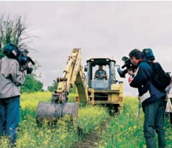
Spatenstich im Windpark Teterchen Wind park Teterchen - start of the construction works
