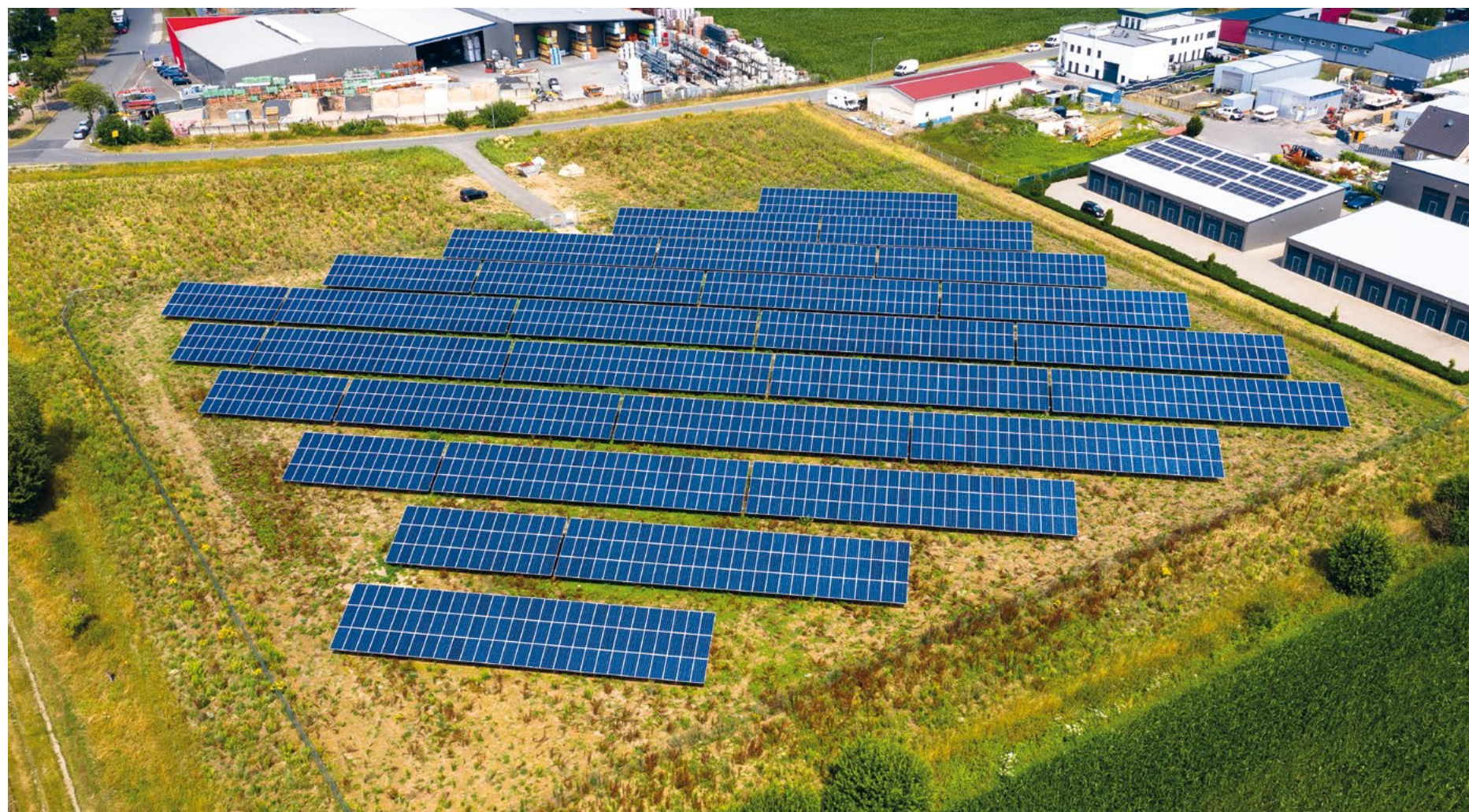
Fertiggestellte PV-Anlage PV-Anlage (Dülmen 2019)
