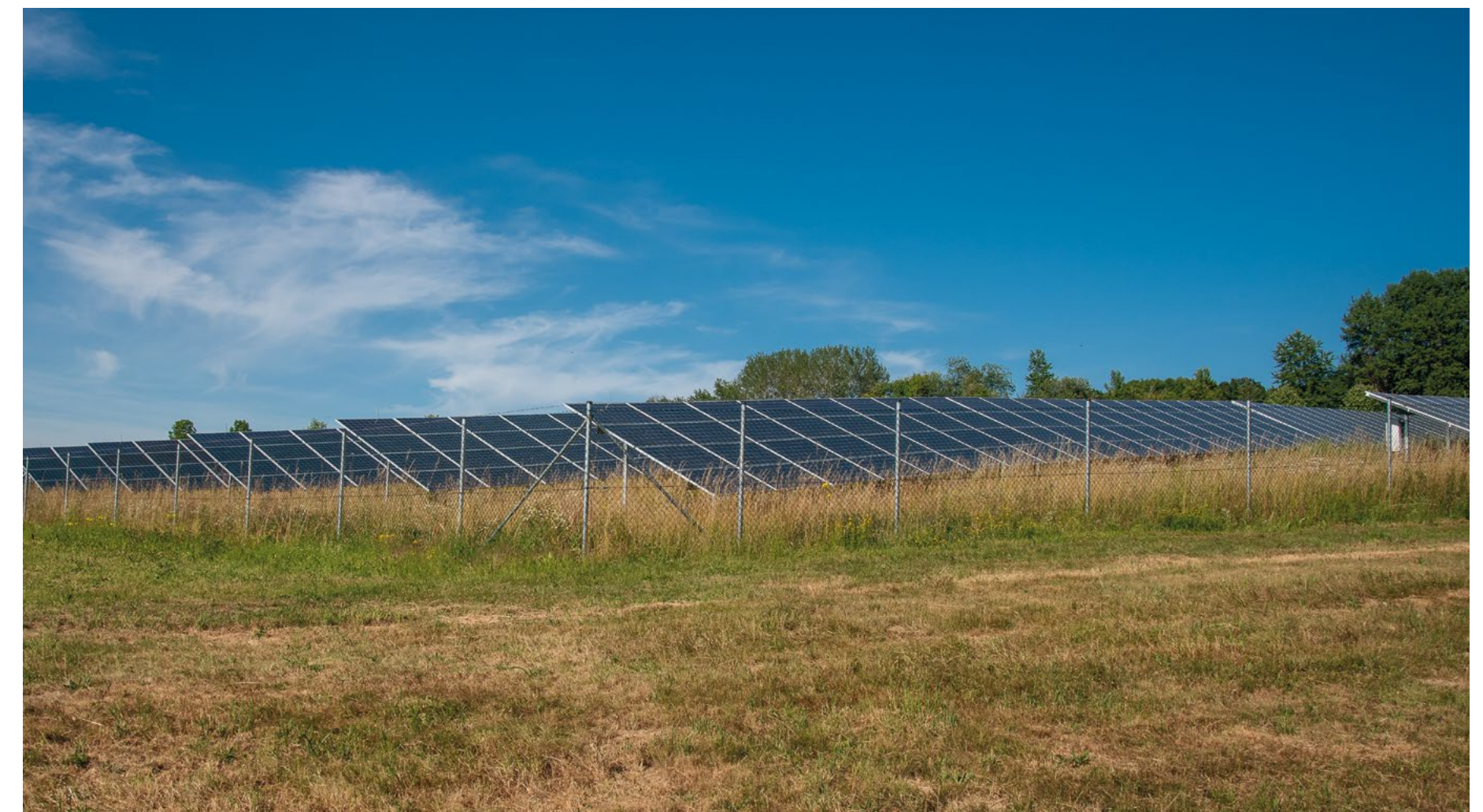
Fertiggestellte PV-Anlage PV-Anlage mit Zaun (PV-Anlage Malborn; 2018)
